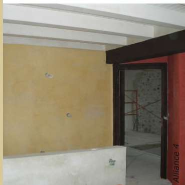
Des enduits à la chaux neutres sont mis en teinte par des glacis jaune et rouge.
